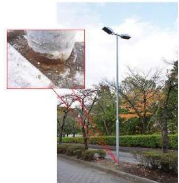
街路灯の腐食
